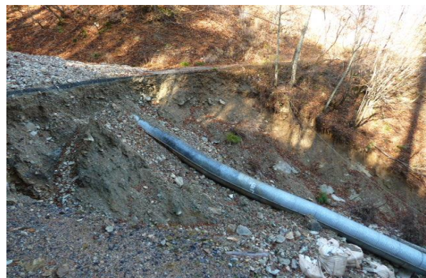
豪雨による路体の欠損状況
