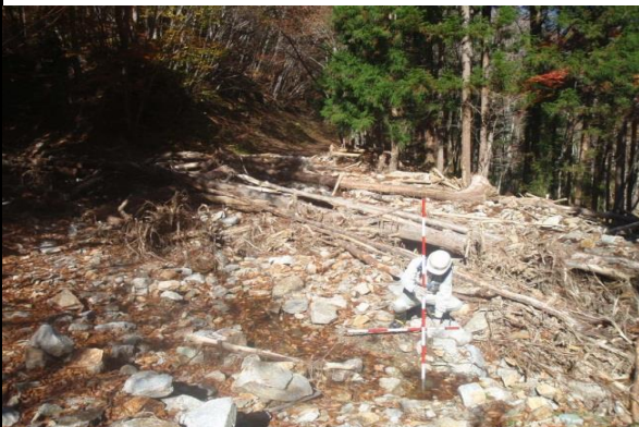
豪雨による路体の流亡状況
