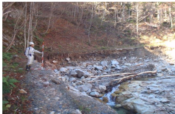
流水による路肩決壊状況
