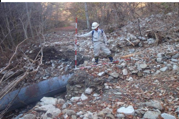
林道の暗渠の被害状況
